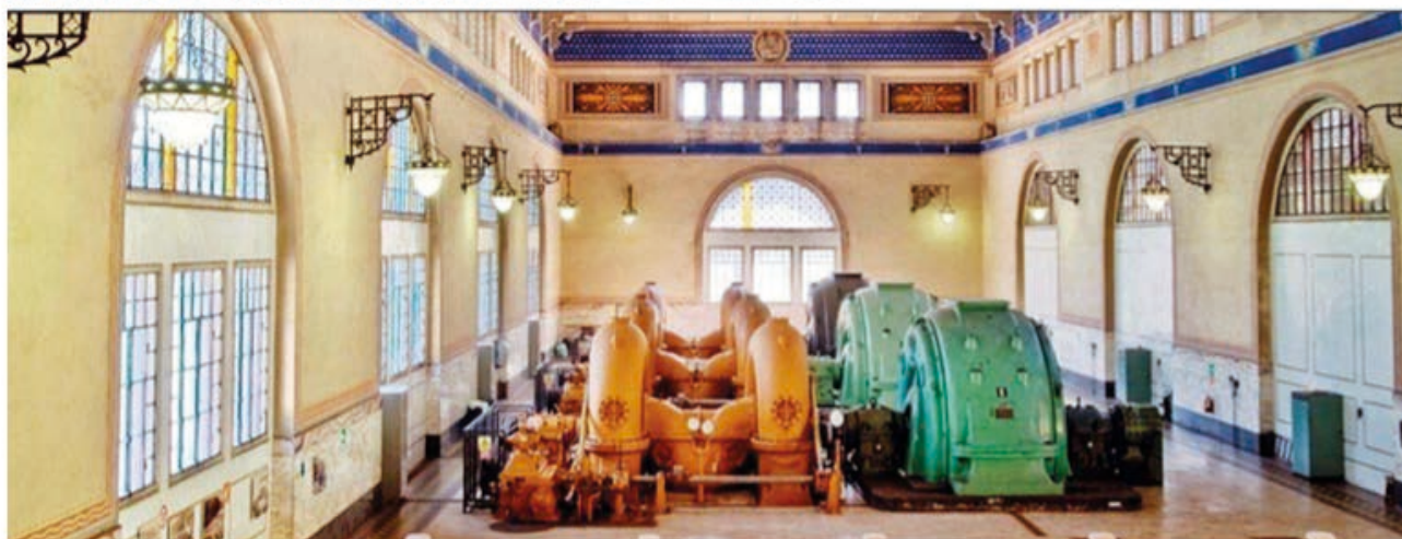
La sala macchine della centrale idroelettrica dell'Enel a Nove di Vittorio Veneto sarà aperta al pubblico domenica pomeriggio, qui si terrà l'incontro con il gionalista e scrittore Roberto Bonzio
